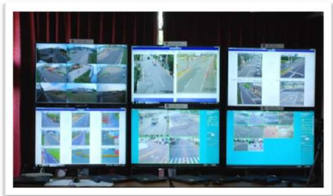
運用監視錄影系統掌握展區內、外治安及交通狀況
